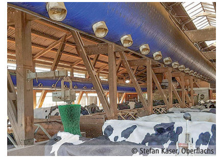
Schlauchlüftung oberhalb des Fressgangs und der Liegeboxen
